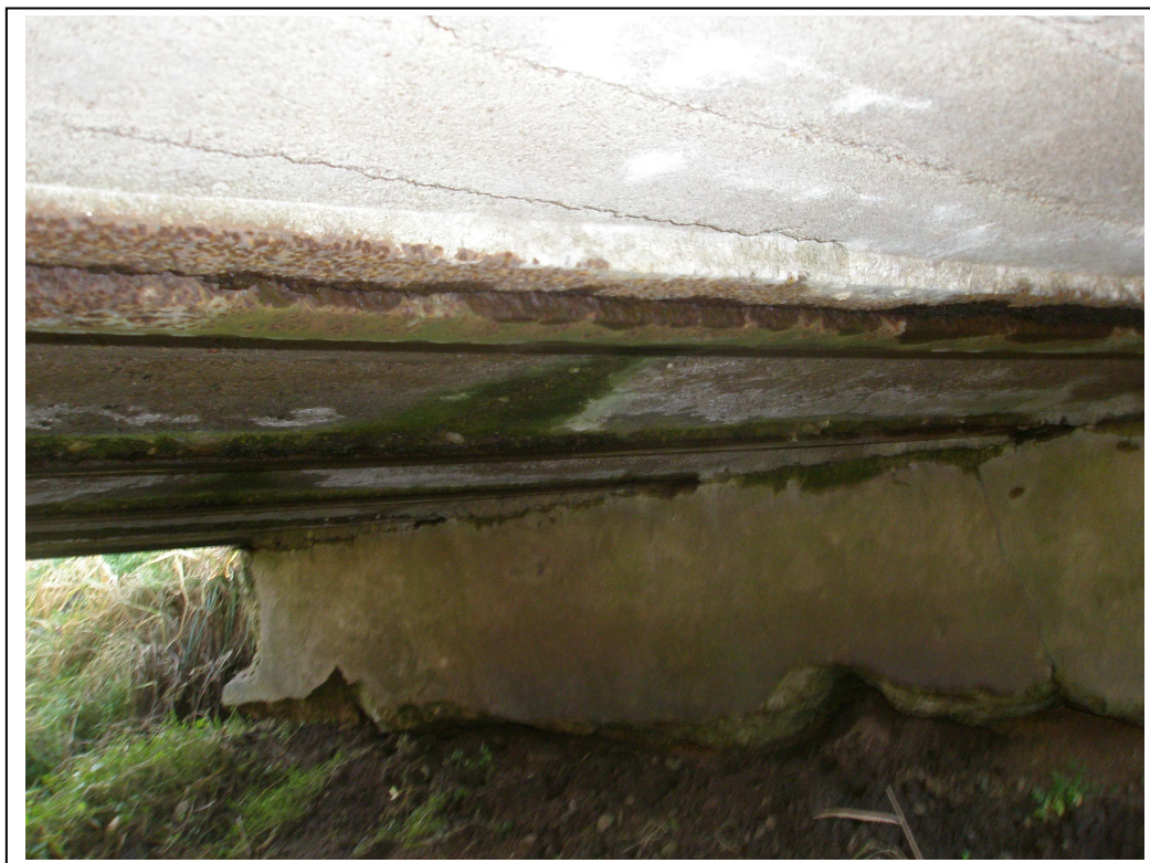
FOT. - 3 Pęknięty przyczółek, ubytki betonu, korozja dźwigarów
