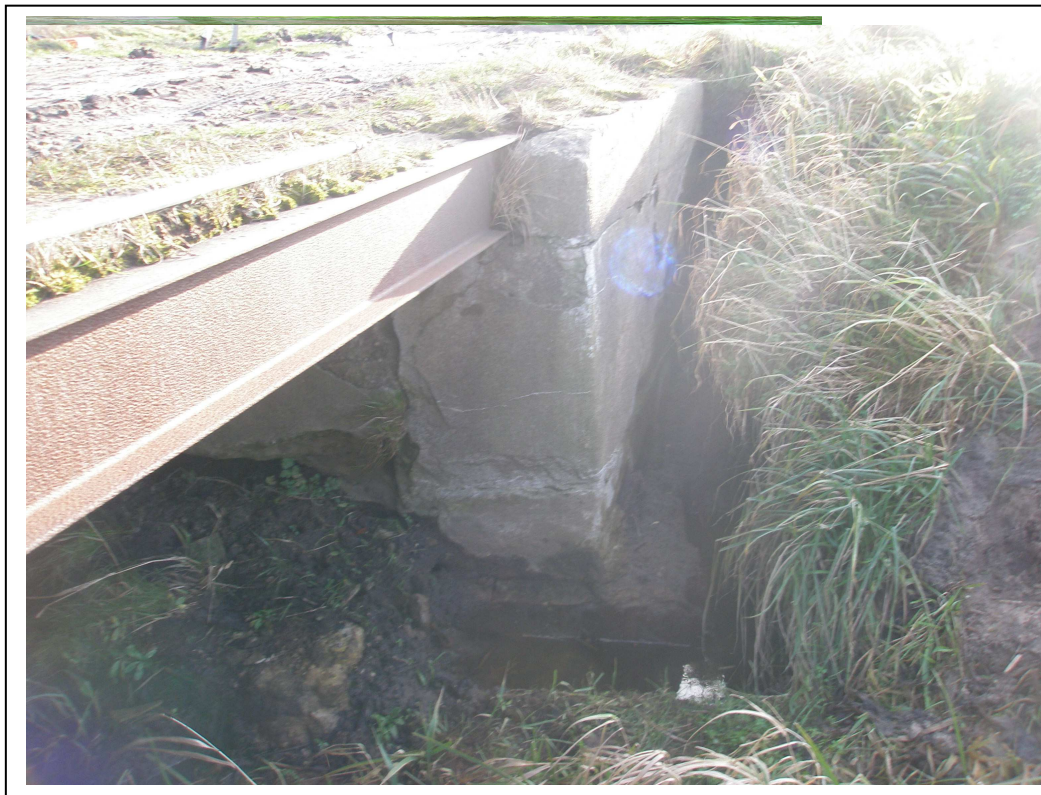
FOT. - 4 Pęknięty przyczółek, ubytki betonu, korozja dźwigarów, pęknięte skrzydełko
