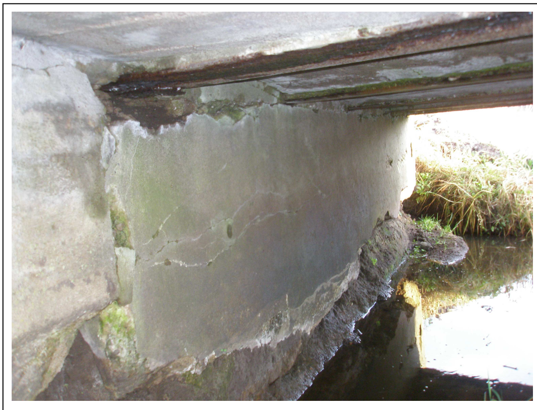
FOT. - 2 Pęknięty przyczółek, ubytki betonu, korozja dźwigarów
