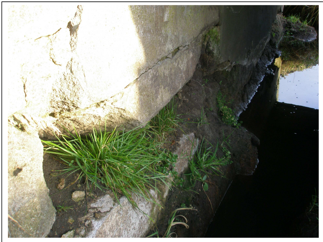
FOT. - 1 Pęknięty przyczółek, ubytki betonu
