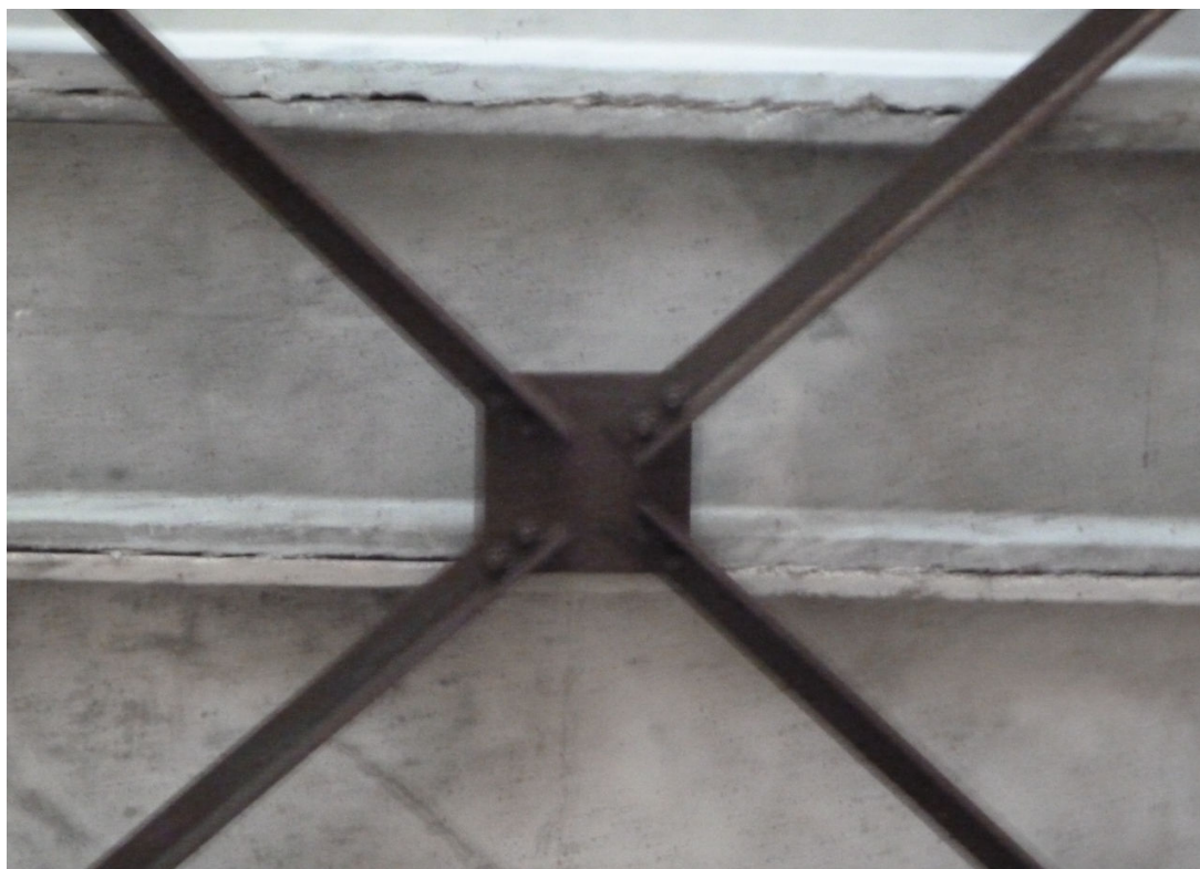
Zdjęcie nr 11 – Połączenie śrubowe stężenia połaciowego – widok z bliskau
